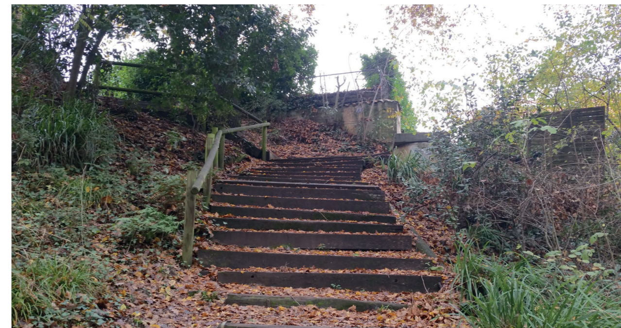
Main courante à réhausser (en haut à gauche)
